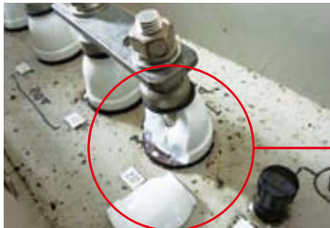
→ 硝子がかげ送電ができない状態復旧にかなりの時間を要します。
